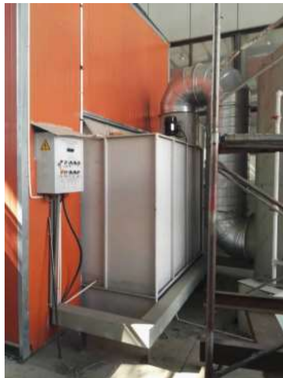
喷漆房废气水帘措施外部照片
